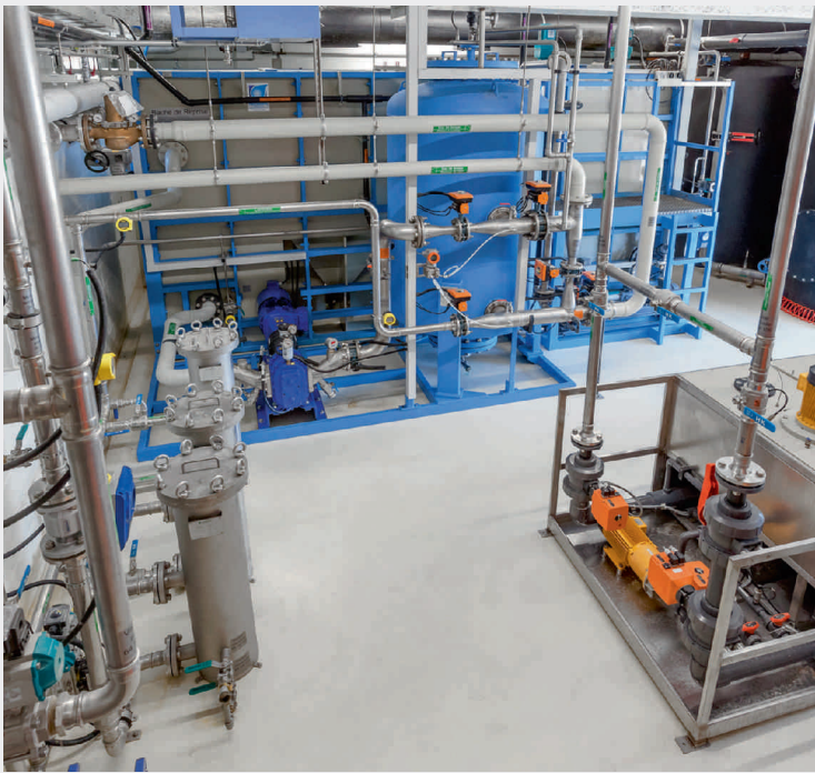
Fig. 3 Installation de traitement des centrats par stripping membranaire de la STEP d'Yverdon-les-Bains: Skid de décantation (à gauche), filtre à sable (au milieu) et installation de stripping membranaire de l'ammoniaque (à droite).
