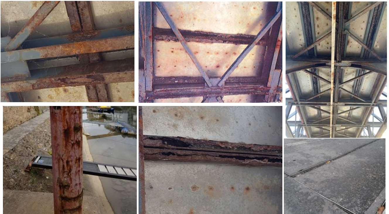
Figure 2 : Etat de corrosion de l'ouvrage
