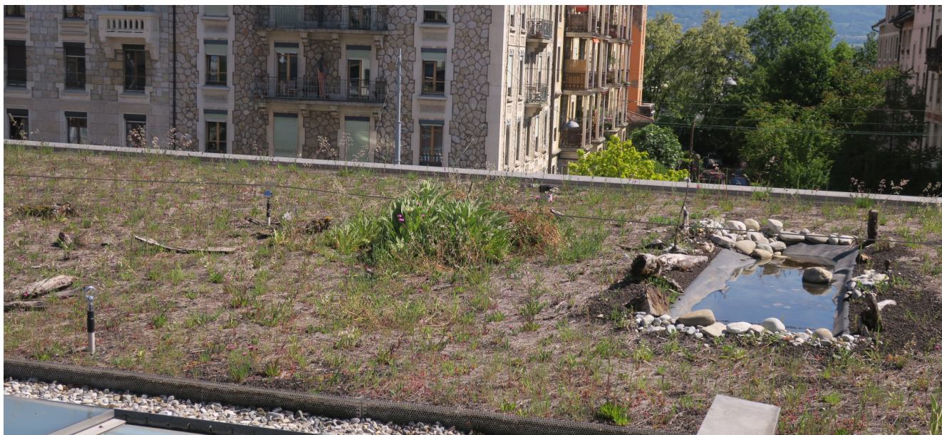
Intégrer de petits aménagements sur une toiture végétalisée augmente son attractivité pour les espèces animales. Ici une mare avec un tas de pierre, une zone refuge dans la prairie et des morceaux de bois (© Atelier Nature et Paysage)
